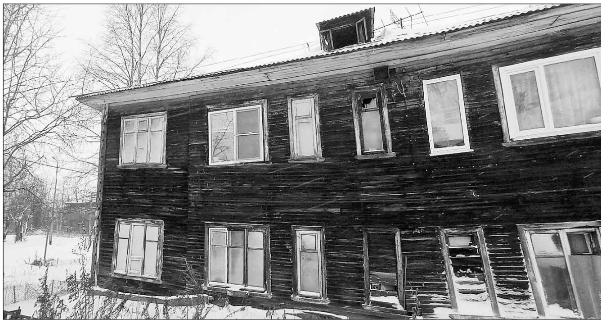
■ Улица Бергавинова, 7: жильцы уже год не могут добиться, чтобы отремонтировали дверь в бойлерную и утеплили коммуникации, так как в морозы замерзает холодная и горячая вода
